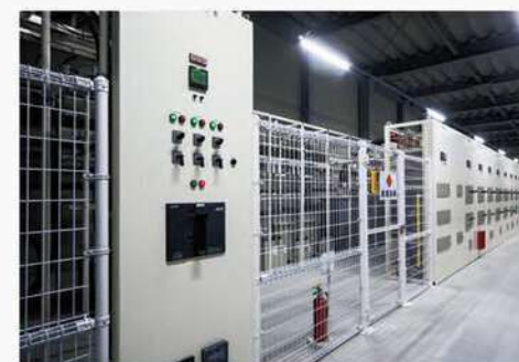
受変電、幹線、動力設備
