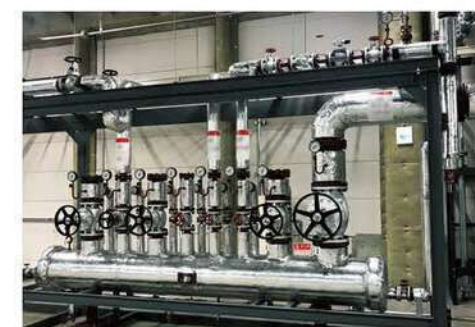
ユーティリティ設備
