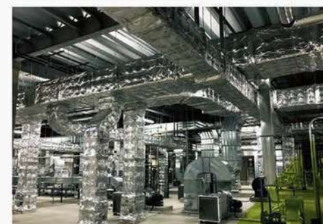
給排気ダクト
