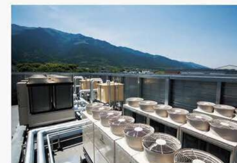
空調（冷暖房）設備
